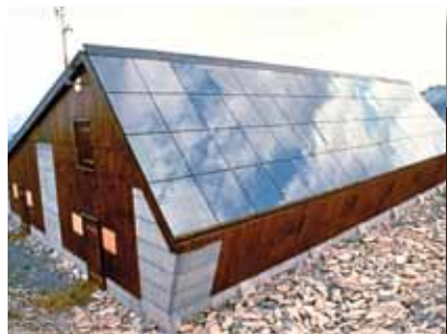
> Toiture complète en photovoltaïque
