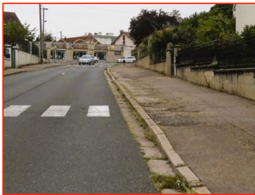
Figure 55 Traversée non aux normes à Auxerre
