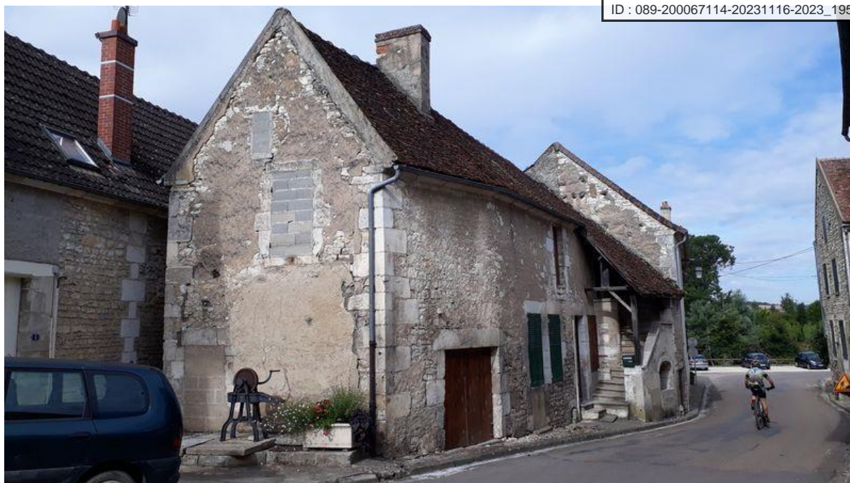
Figure 27 : exemples de bâti dégradé – photographies 1 à 3 sur carte (photographies CDHU)
