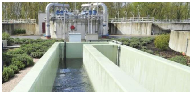
Station d'épuration d'Appoigny
