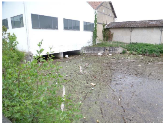
Vue sur la zone d'embâcle au niveau du « goulet d'étranglement » sur le bras de dérivation
