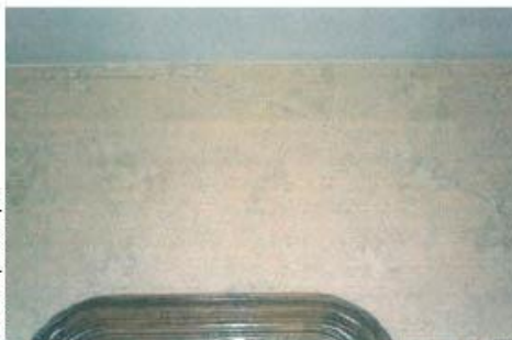
Fissuration intérieure, tapisserie déchirée - Maison André.
