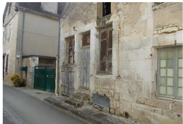
Photo 24 - Bâti vacant non entretenu
