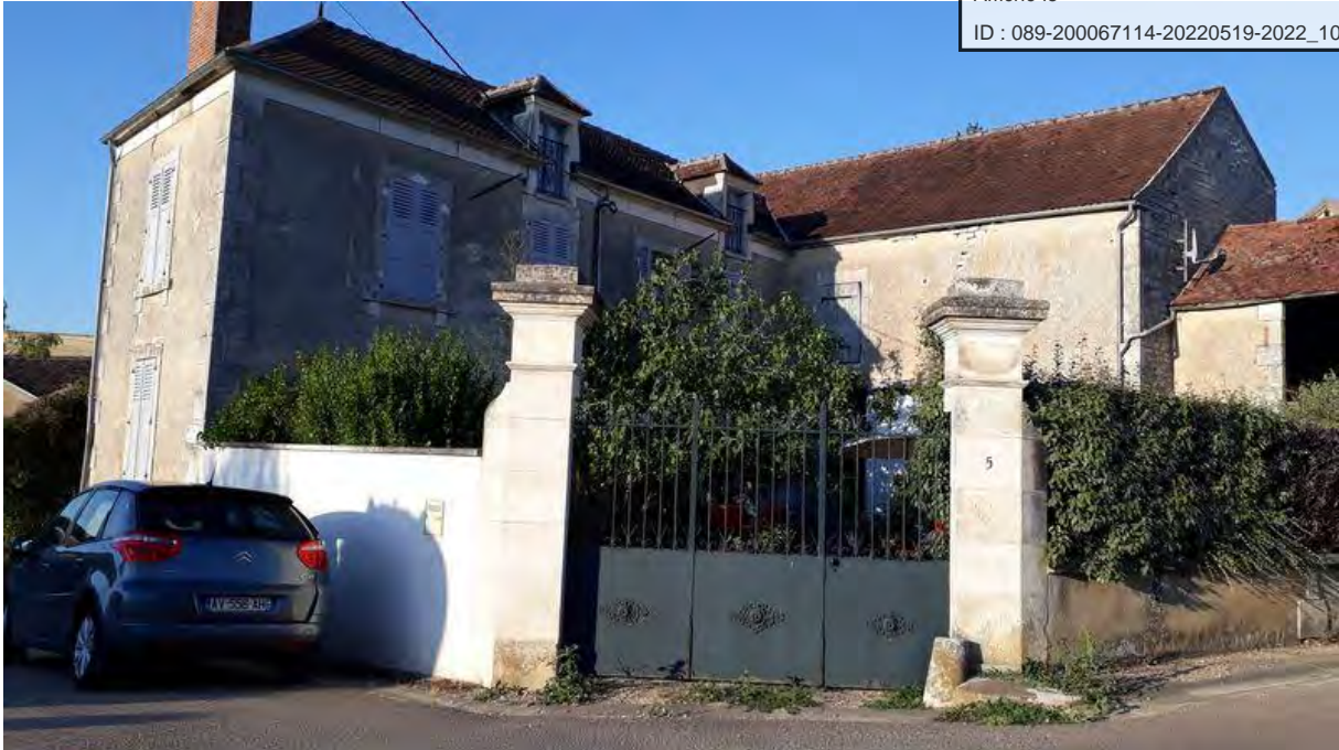
Figure 29 : exemples de bâti dégradé – photographies 1 à 3 sur carte (photographies CDHU)
