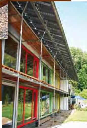
> Photovoltaïque en toiture avec auvent
