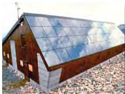
> Toiture complète en photovoltaïque
