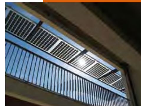
> Capteurs photovoltaïques en brise-soleil
