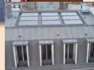
> Capteurs thermiques sur toiture zinc (Eau chaude solaire collective)
